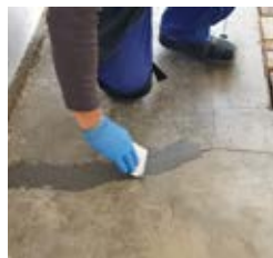
Etanșați fisurile din beton.
